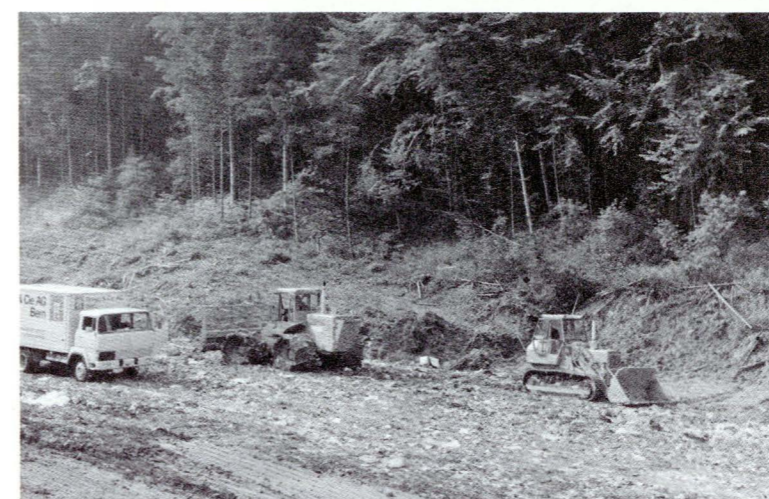
Links bringt ein Lastwagen Material, das vom Kompakter (Mitte) planiert und zusammengepreßt wird.
