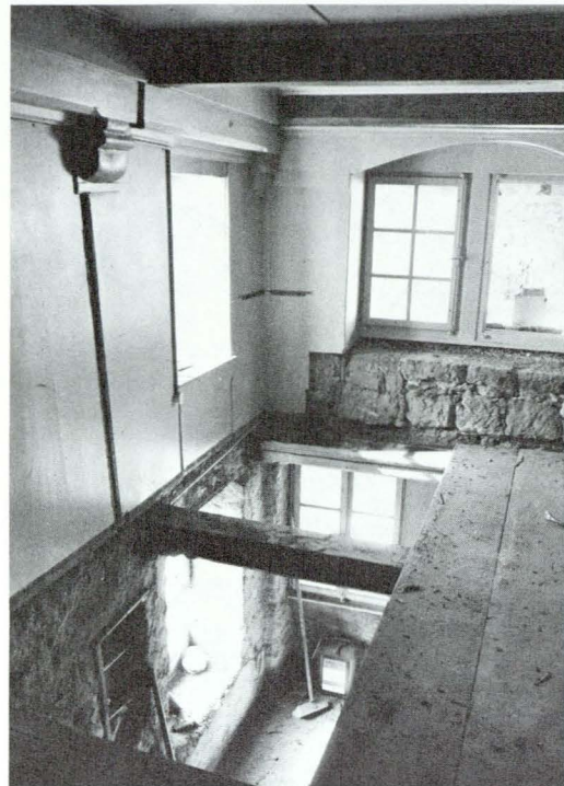
Alte Kaplanei Laupen. Frühere Bausünden gilt es zu korrigieren.
