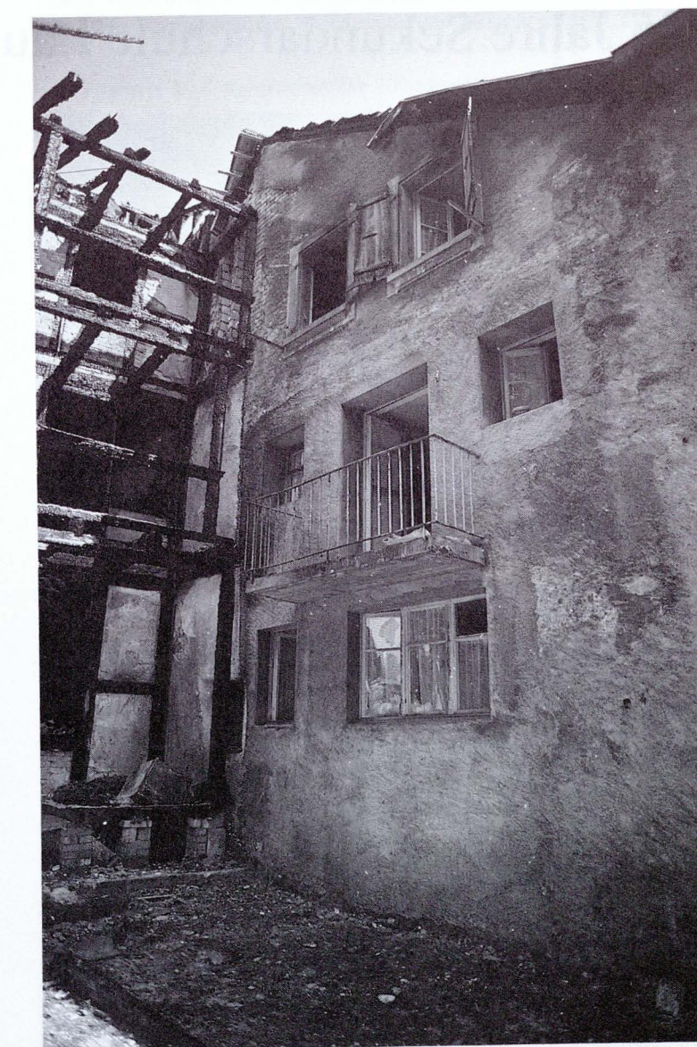
Blick auf die Rückseite der Flüchtlingsunterkunft und auf die stark beschädigten Nachbargebäude. Foto: F. Tanner
