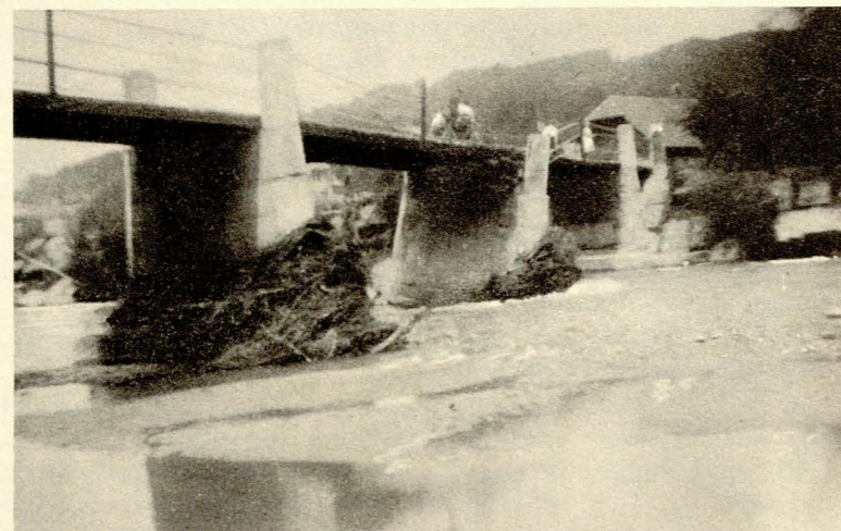
Die Brücke nach dem Hochwasser vom 10. Mai 1936
