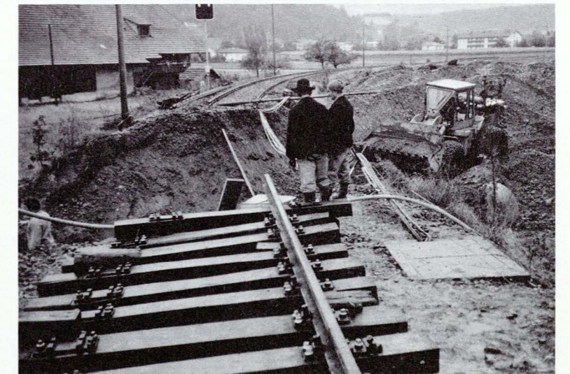
Die offene Bauweise unterbrach den Eisenbahnbetrieb. Mit einem Car wurde der Verkehr aufrecht erhalten.
