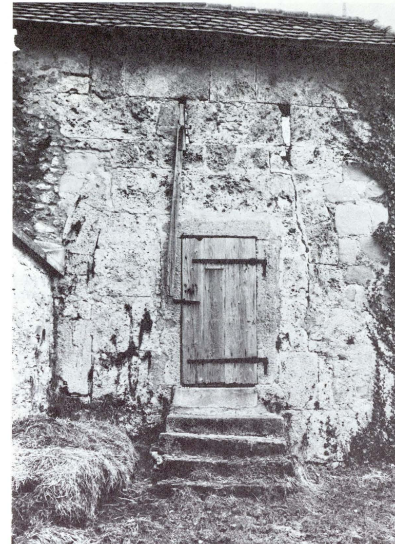
Das ehemalige Westtor, durch das man früher in den Zwinger beim Käfigturm gelangte, ist in der Wehrmauer noch gut ablesbar.
