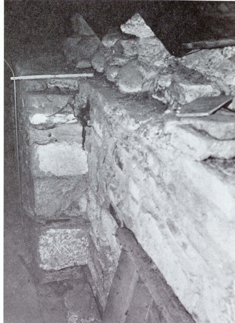
Die Lage und die Ausmasse des nordseitigen Palasdacherkers lassen sich im Dachstuhl und in den Fehlstellen der nordseitigen Mauerkrone klar ablesen. Im Hintergrund die originale Mauerkrondicke. Im Vordergrund die zugemauerte Fehlstelle nach der Entfernung des Dachkers.
