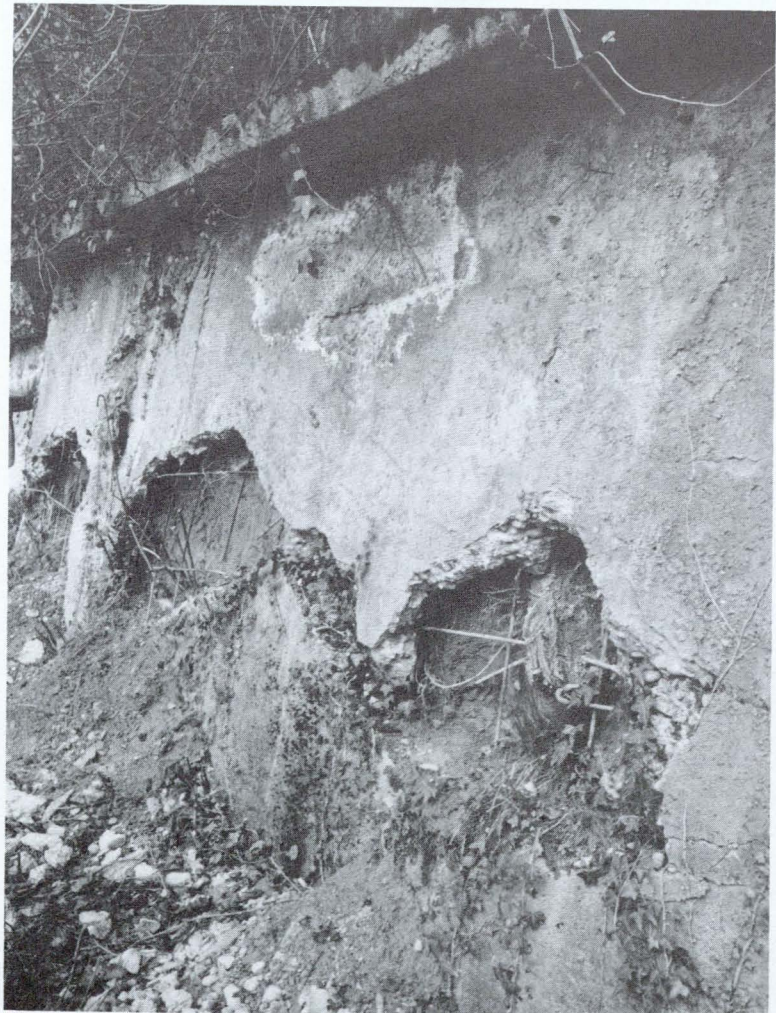
Schäden an der Verbauung 1923/25.
