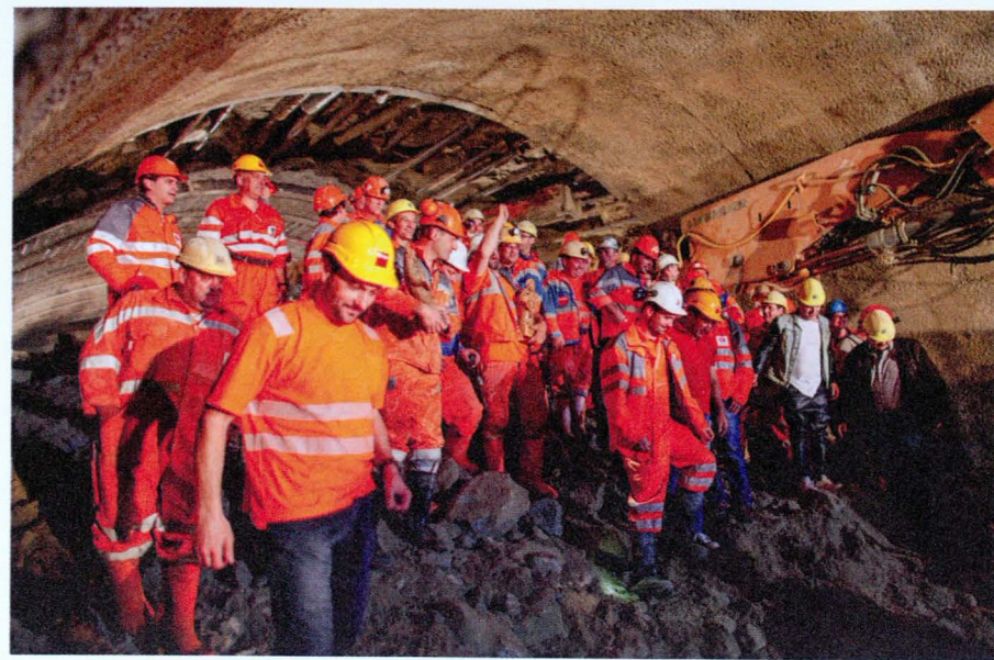
Links: «Freude herrscht» am Tag des Durchschlags – einer der Höhepunkte bei jedem Tunnelbauprojekt.
