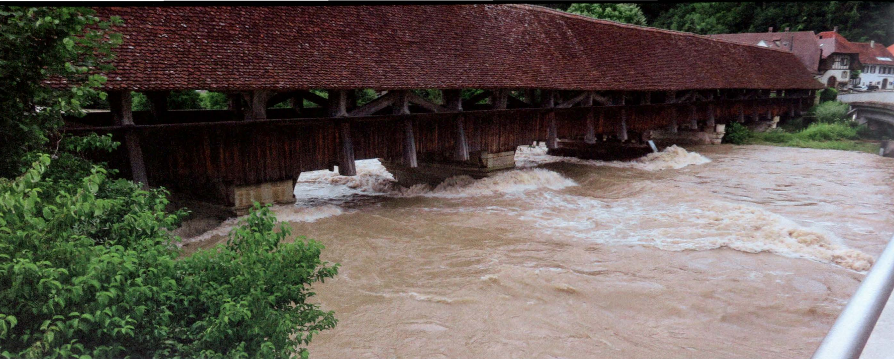
Hochwasser an der Saane: alte Holzbrücke Gümmenen.
